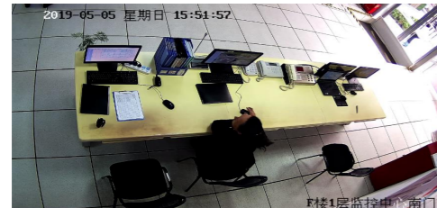
消控室人员在离岗
